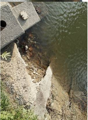
【取水施設破損箇所】
